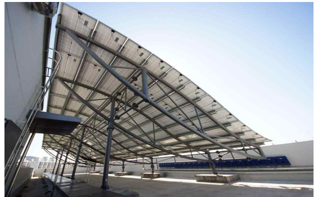
※옥상에 설치된 태양광 전지판
