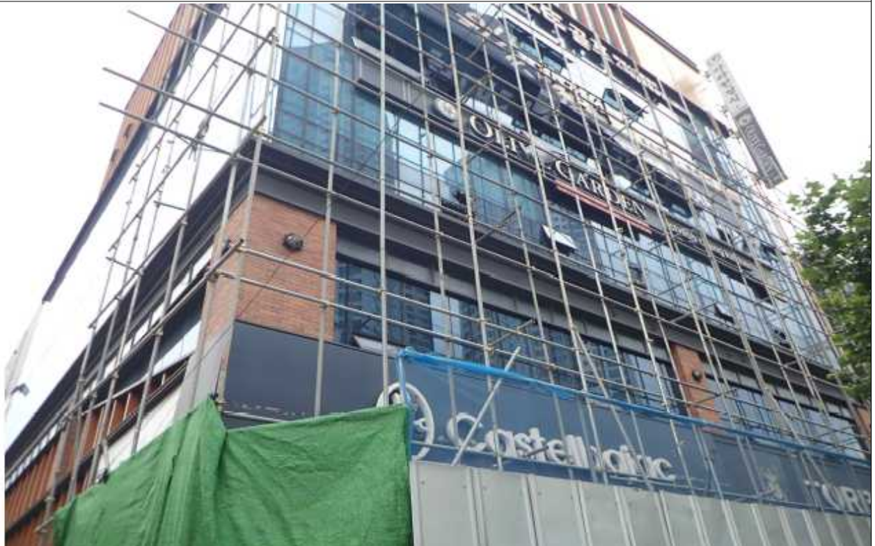
해체공사 주변 통행로에 대한 안전조치 미시행(낙하물방지망 미설치)
