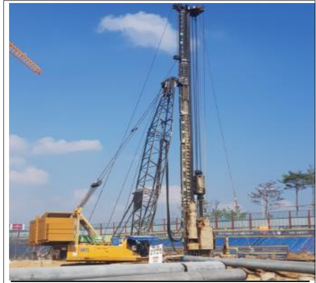
불법 구조변경된 건설기계 (항타용 작업장치로 변경한 기중기)
