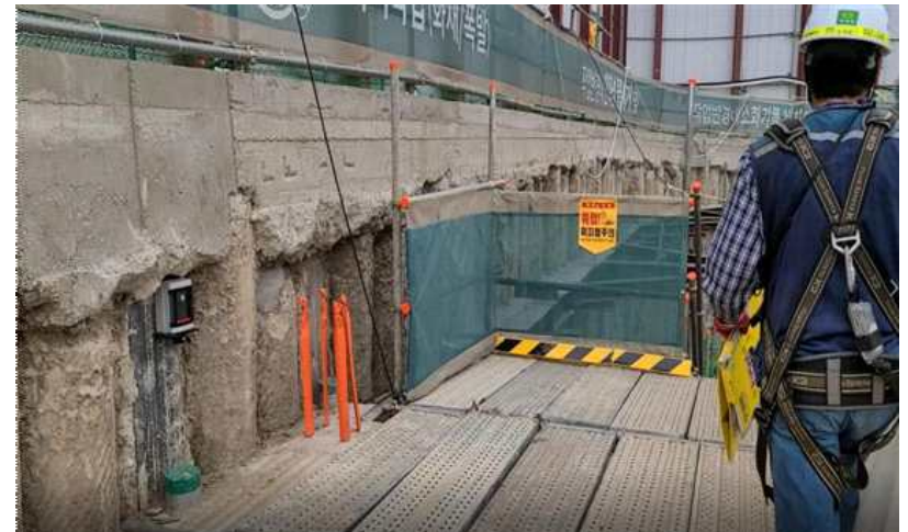
개선 후 위험지역 위험알리미 설치 사용
