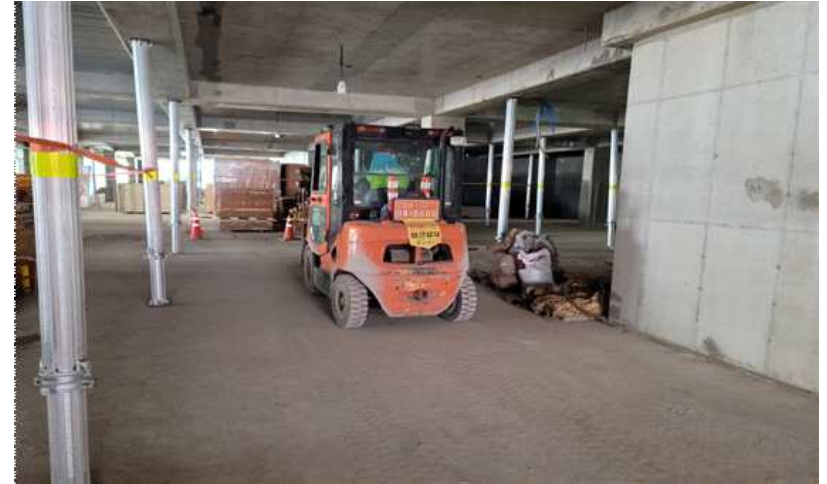
개선 전 지게차 하역운반 작업 시 근로자와 충돌 및 협착 위험
