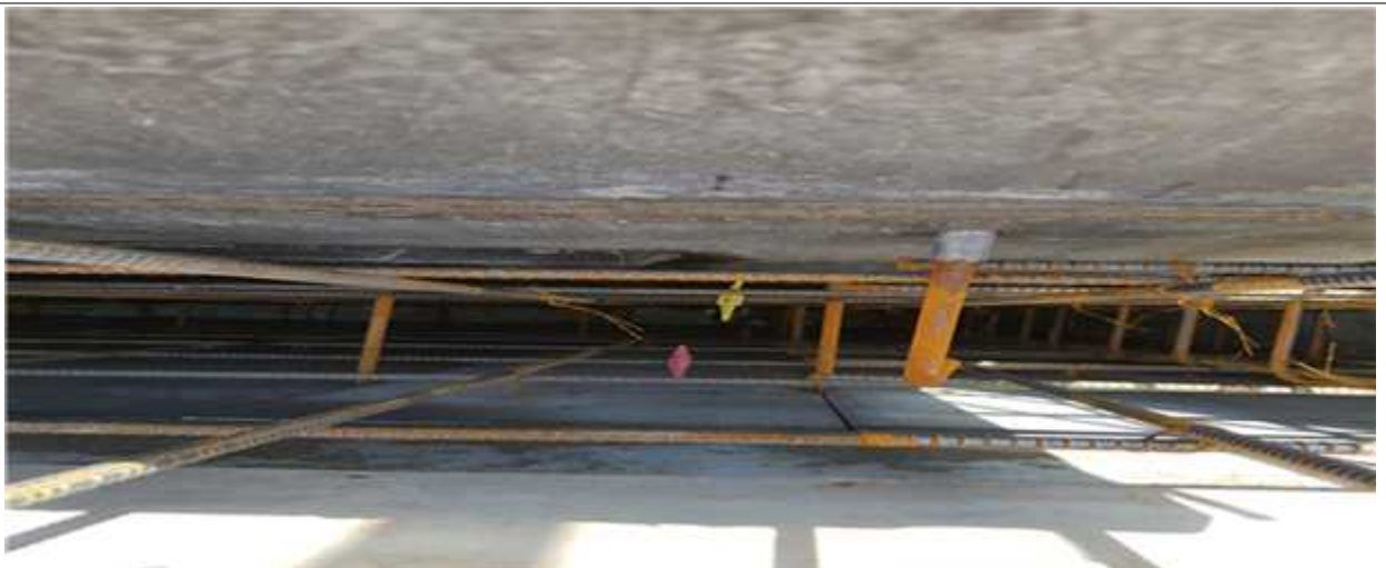
벽체 수직·수평철근 결속 불량으로 보완조치에 따른 공사중지(13일간)
