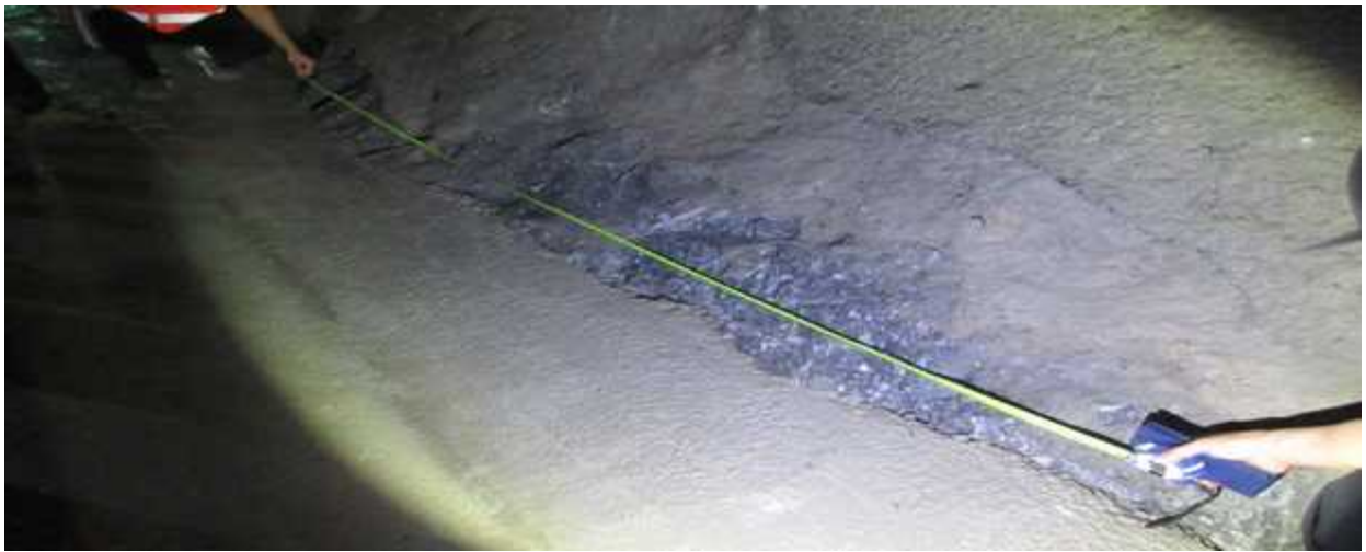
터널 숏크리트 시공이 미흡으로 보완조치에 따른 공사중지(12일간)
