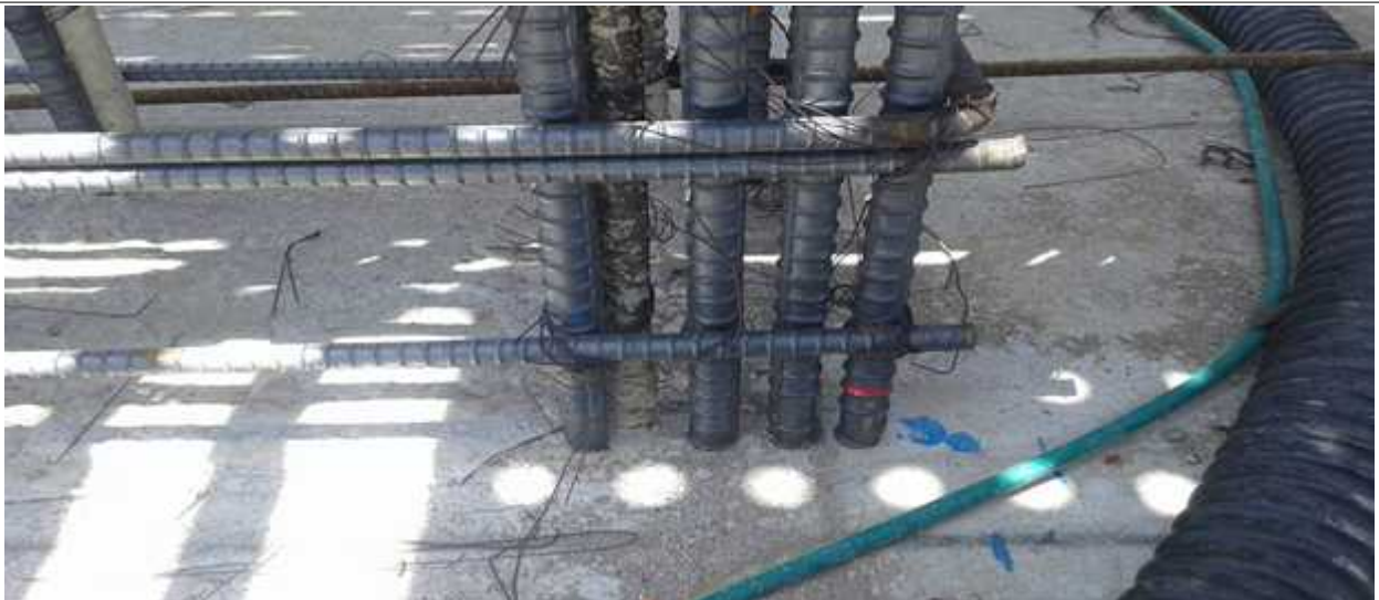
수직벽체 철근배근 오시공으로 보완조치에 따른 공사중지(8일간)
