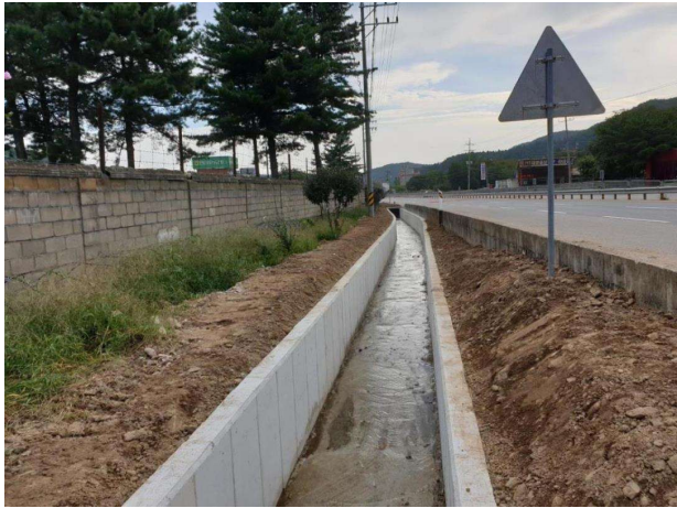
▲ 배수시설 퇴적물 청소 우수
