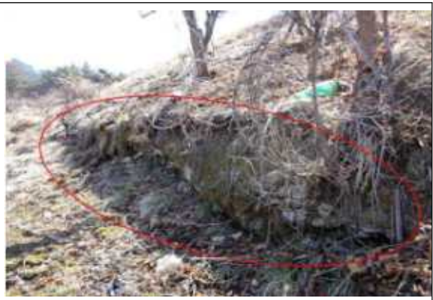
콘크리트 응벽 파손
