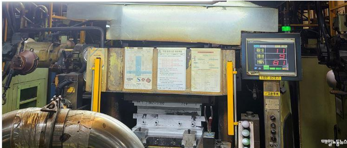
▲ 대흥알엔티의 성형공정 국소배기장치 모습. <금속노조 경남지부 대흥알엔티지회>
