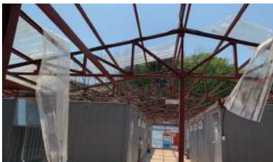
사고발생 현장 전경
