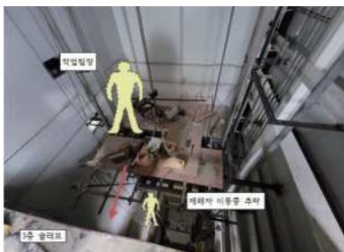
엘리베이터 내부(PIT) 사고 전경
