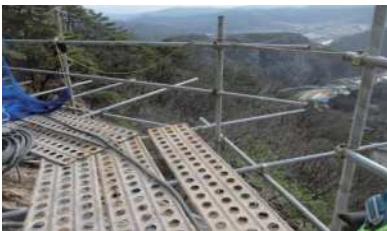
사고발생 현장 전경
