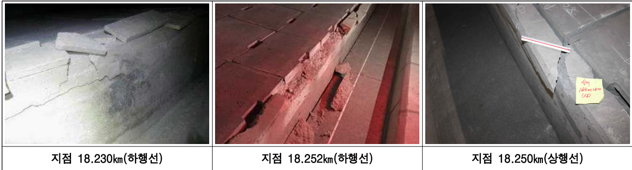
[사진 5] 울현터널 제3-1공구의 공동구 벽체 손상 사진
