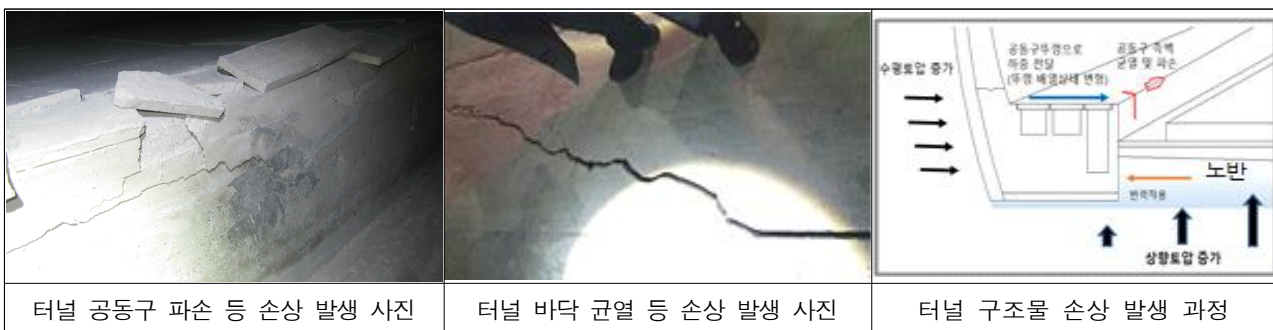
[사진 4] 율현터널의 용기 발생 및 손상 사진
