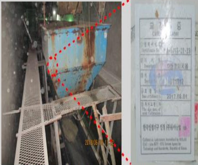
< 계량장치(호퍼저울) 전경 및 교정필증 >
