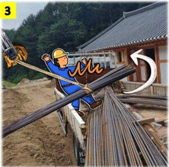
철근 다발이 회전해면서 작업자를 타격!!
