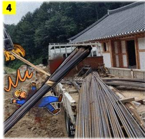
작업자와 철근다발이 동시에 추락하여 사망! (17t, 약 1ton)
