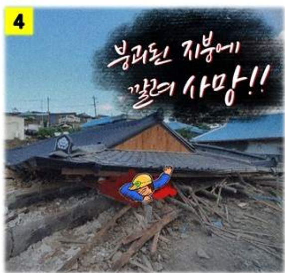
4 앉아서 휴식하던 작업자 1인 미처 대피하지 못해 매몰·사망!!
