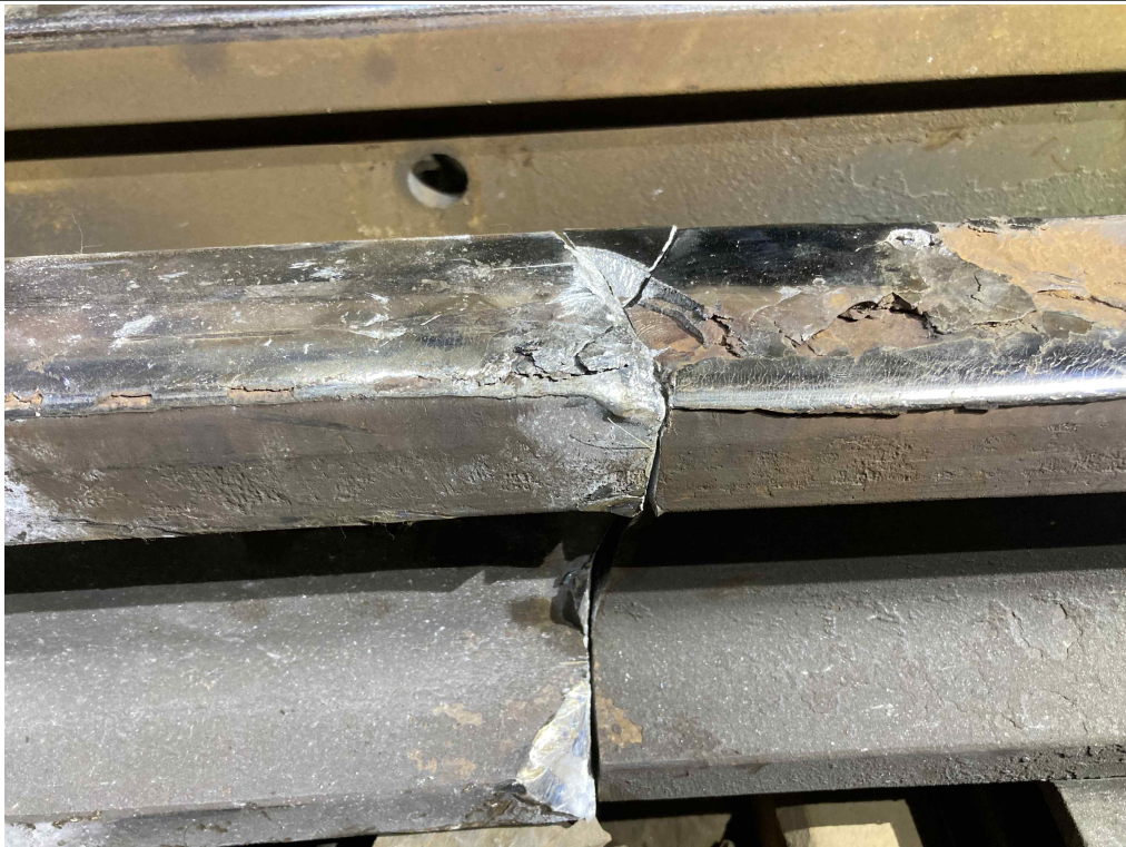
사고 이후 파손된 레일 파손을 수거하여 조합한 상태의 사진(2)
