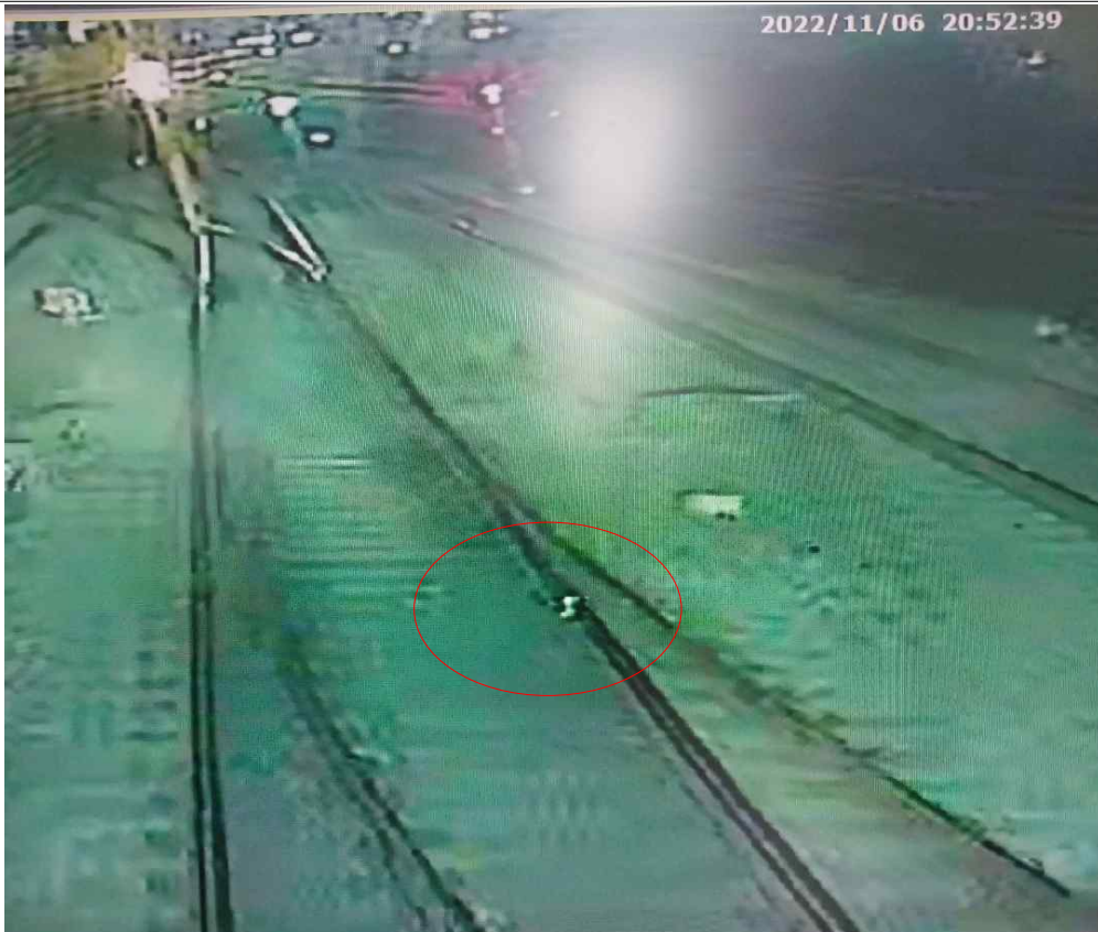
사고발생 열차(무궁화호)의 사고지점 통과전 전방 CCTV 영상 캡처 사진 (레일 절손 파단면 식별됨)
