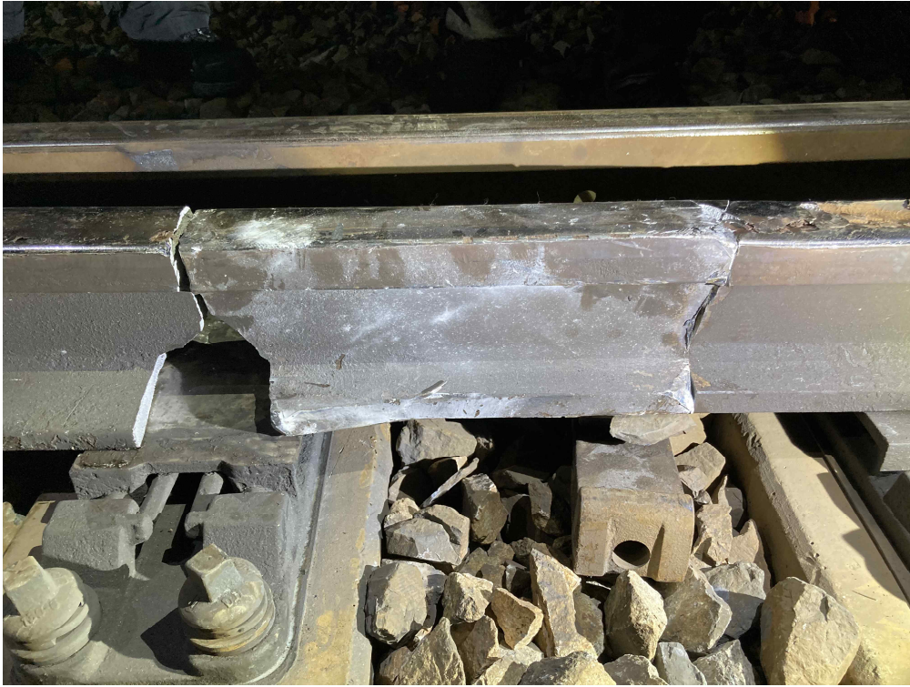
사고 이후 파손된 레일을 수거하여 조합한 상태의 사진(1)
