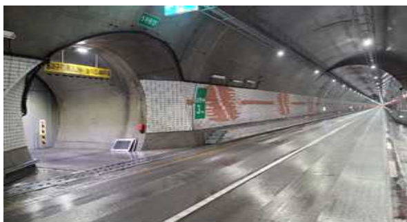
< 터널 내 노면 결로 사례 >
