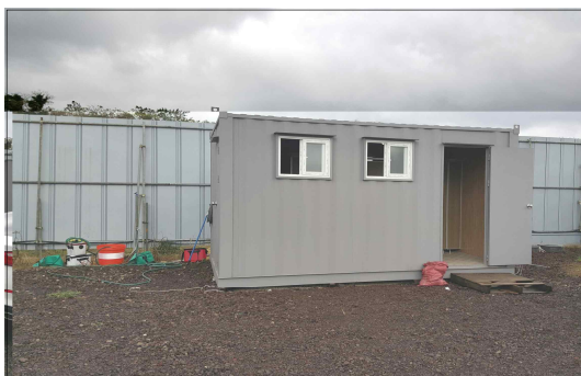
(A) 공사장 이동식 화장실
