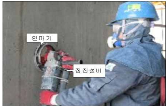
(D) 야외 연마작업시 집진설비 설치
