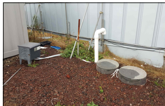
(B) 매립 설치된 정화조
