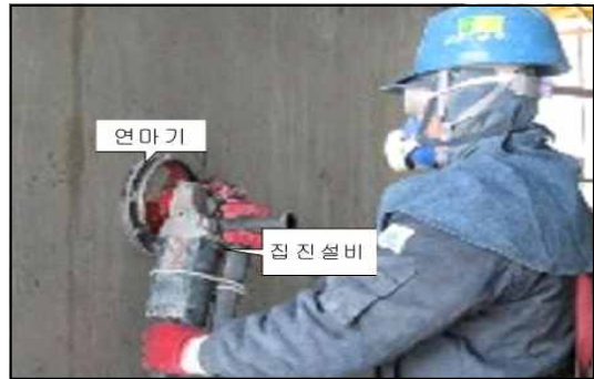
(D) 야외 연마작업시 집진설비 설치
